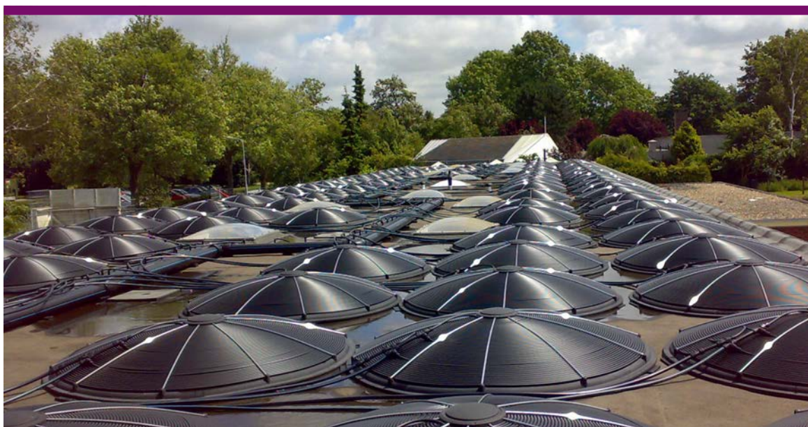
Zonnecollectoren op het dak (Baafje)
